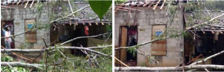
Gambar 75. Foto Dokumentasi Dampak Angin Kencang Kabupaten Kulon Progo
