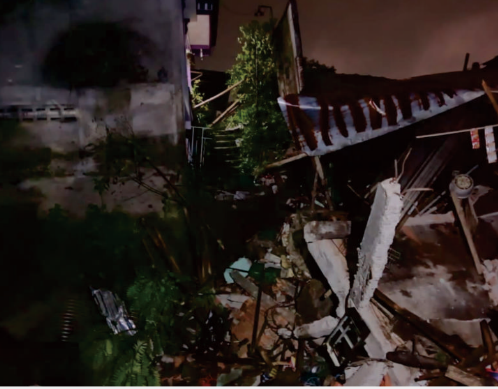
Tanah Longsor | 15-03-25 | Banguntapan, Kab. Bantul F. TRC BPBD DIY
