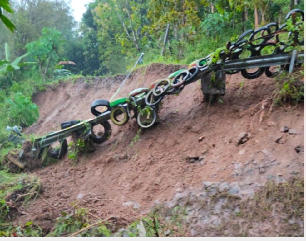
Tanah Longsor | 11-04-25 | Kokap, Kab. Kulon Progo F. Relawan Kab. Kulon Progo
