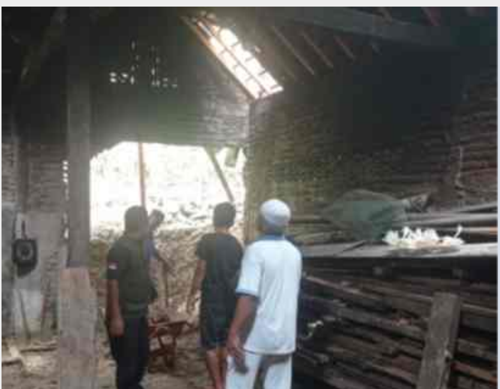
Tanah Longsor | 28-10-25 | Panjatan, Kab. Kulon Progo F. BPBD Kab. Kulon Progo
