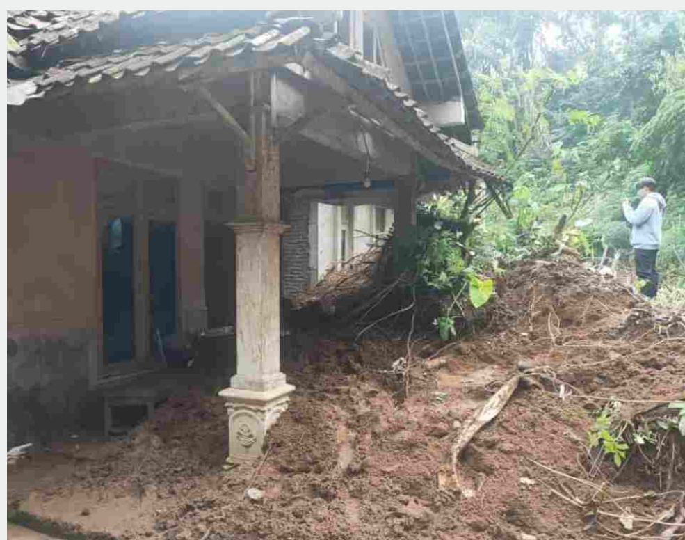
Tanah Longsor | 29-01-24 | Samigaluh, Kab. Kulon Progo F. Relawan Kab. Kulon Progo
