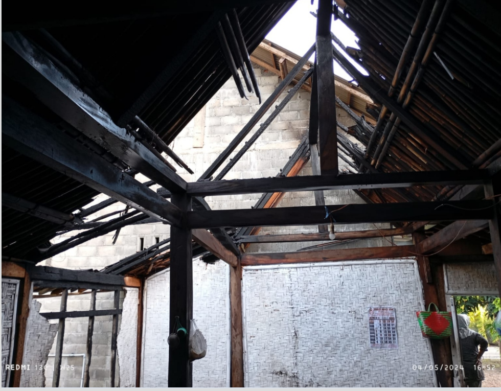
Kebakaran | 04-05-24 | Wates Kab. Kulon Progo F. Relawan Kab. Kulon Progo
