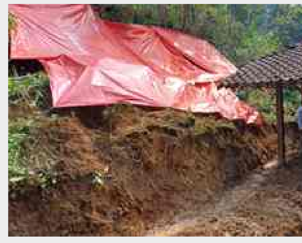
Tanah Longsor | 24-04-26 | Pengasih, Kab. Kulon Progo F. Relawan Kab. Kulon Progo
