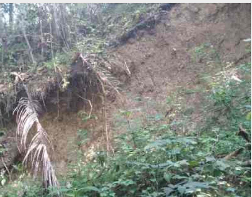
Tanah Longsor | 05-06-26 | Lendah, Kab. Kulon Progo F. TRC BPBD Kab. Kulon Progo
