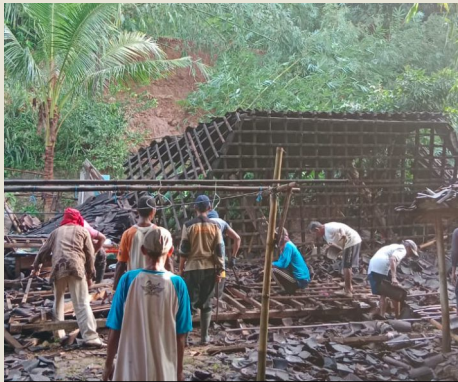
Rumah warga roboh akibat tanah longsor | 26-04-24 | Ngawen Kab. Gunungkidul | F. Relawan Kab. Gunungkidul
