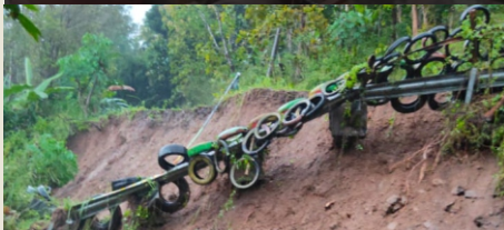
Talud jalan longsor mengancam 3 rumah di bawahnya | 11-04-25 | Jl Bendo-Suroloyo, Sidoharjo, Samigaluh, Kulon Progo | TRC BPBD DIY
