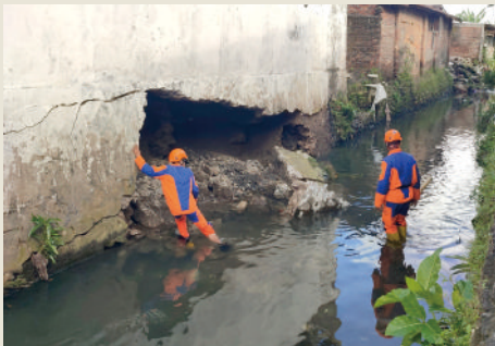
Talud ambrol | 11/04/2026 | Gondokusuman, Yogyakarta | TRC BPBD Kota Yogyakarta
