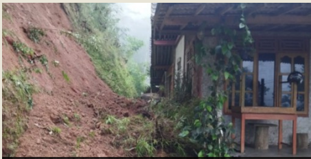
Tebing tanah longsor mengancam rumah | 21-10-25 | Gembosari, Samigaluh, Kulon Progo | BPBD Kab. Kulon Progo
