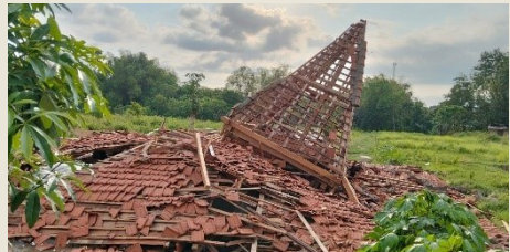
Rumah joglo roboh / rusak berat | 15-10-25 | Gedung RT 06 RW 05, Sinduadi, Mlati, Sleman | TRC BPBD Kab. Sleman
