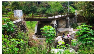
Gambar 2. 2 Kerusakan Infrastruktur Jembatan Sumber: Badan Penanggulangan Bencana Kabupaten Kulon Progo, 2025.
